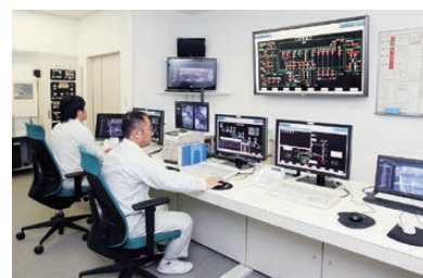
発電所内の制御室
