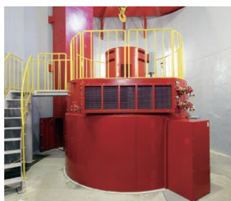
背戸山発電所内部
