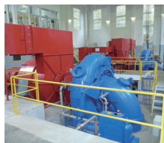
上の代発電所内部
