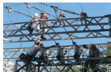
送変電設備の点検
